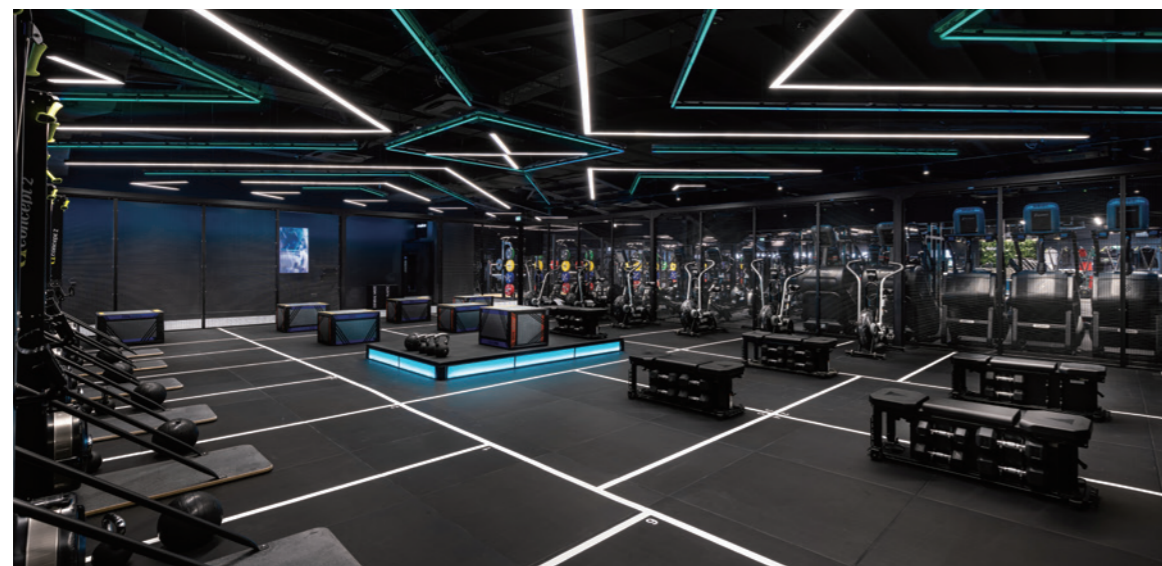
英國Everlast為旗下健身房重新設計LED照明，能藉由燈光區分不同運動區域，並大幅減少80%用電。
